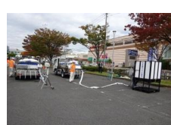
給水(タンク)取出
